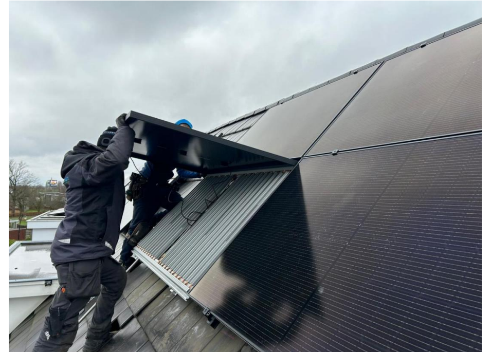
Figuur 15. Installatie PVT panelen 3
