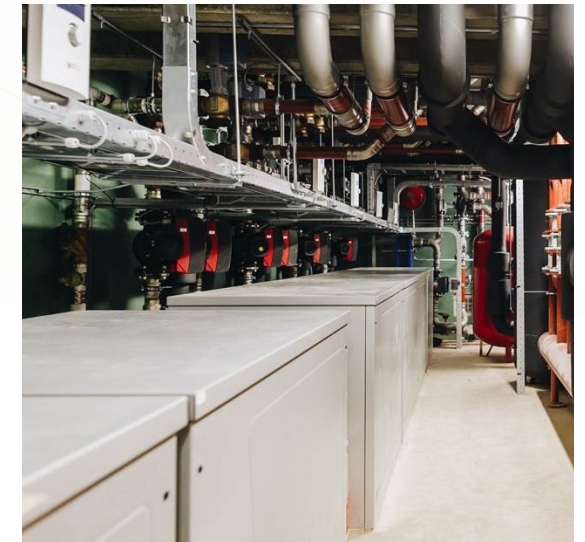
collectieve warmtepomp voor gestapelde bouw
