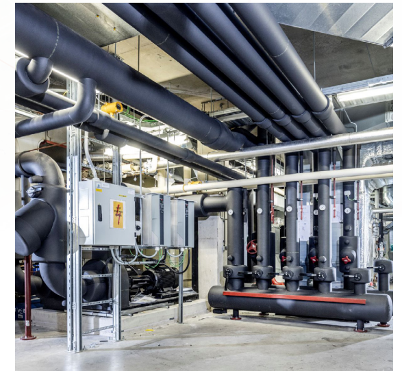
WKO-installatie ruimte. Dit wordt tevens de ruimte voor de pompen van het bronnetsysteem en het TEO-systeem.
